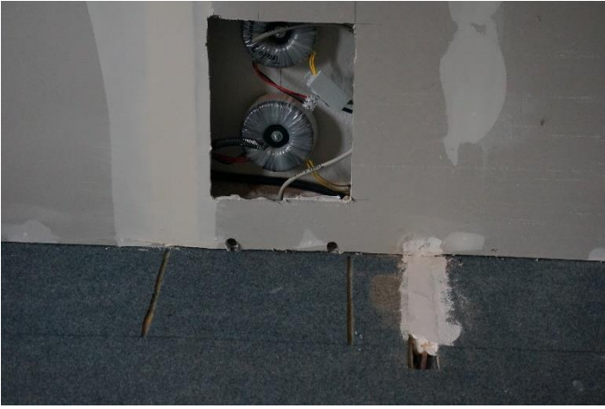
Ansicht Ringtrafo und Temperatursensor im Fußboden für Infrarotflächenheizung
